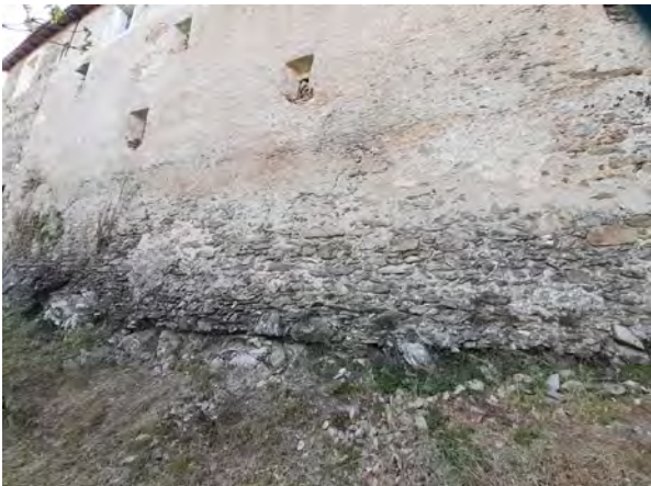
caduta a valle del materiale prima dell'intervento
